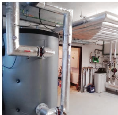
Strojovňa nového systému vykurovania
